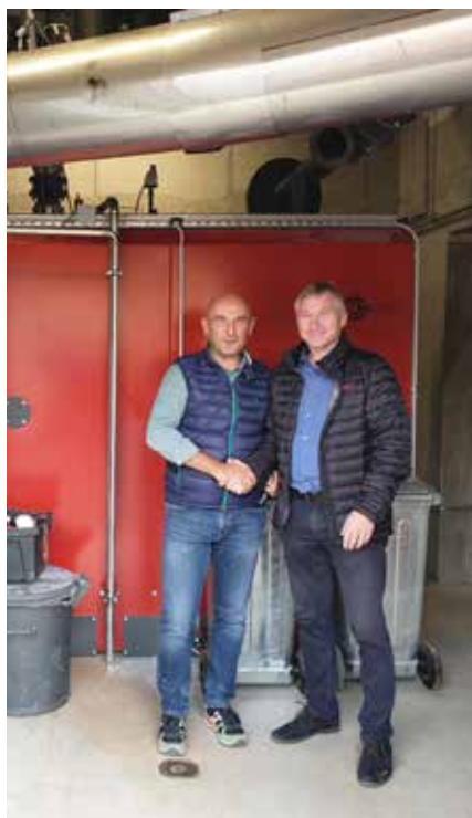
□ Kotlovnica s kotlom Nolting LCS-RU 400/450 kW pri stranki Internova Pazin, Hrvaška
