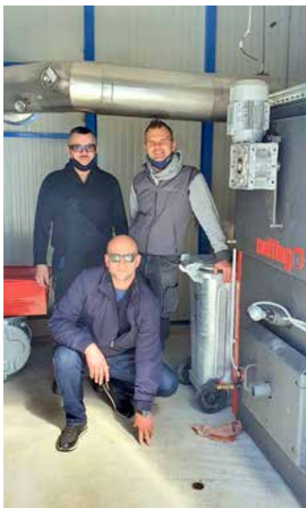
□ Kotlovnica s kotlom Nolting LCS-RU 215/270 kW pri stranki Elektrometal, Poreč, Hrvaška
