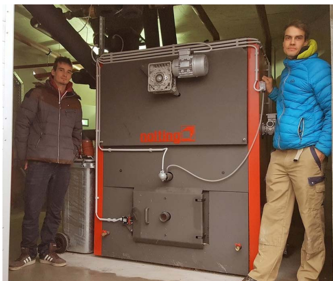
□ Kotel na biomaso Nolting LCS-RU 300/350 kW pri stranki LIPAR, Cerklje na Gorenjskem, Slovenija
