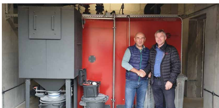
□ Kotao na biomasu Nolting LCS-RU 400/450 kW kod stranke INTERNOVA, Pazin, Hrvatska
