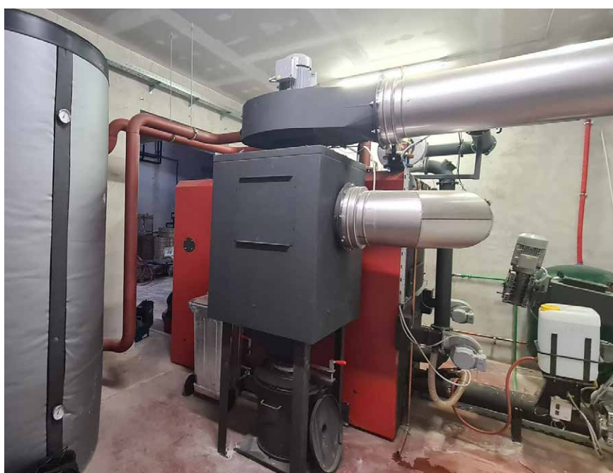
□ Kotlovnica s kotlom Nolting LCS-RU 400/450 kW u tvornici Ferotehna, Otočac, Hrvatska
