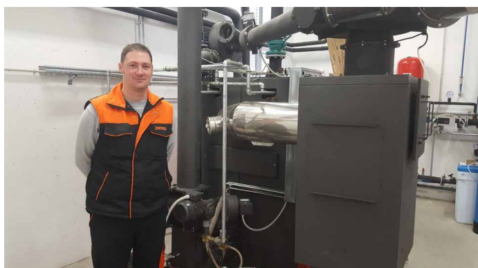
□ Kotao na biomasu Nolting LCS-RU 215/270 kod stranke IVERPAN, Zagreb, Hrvatska
