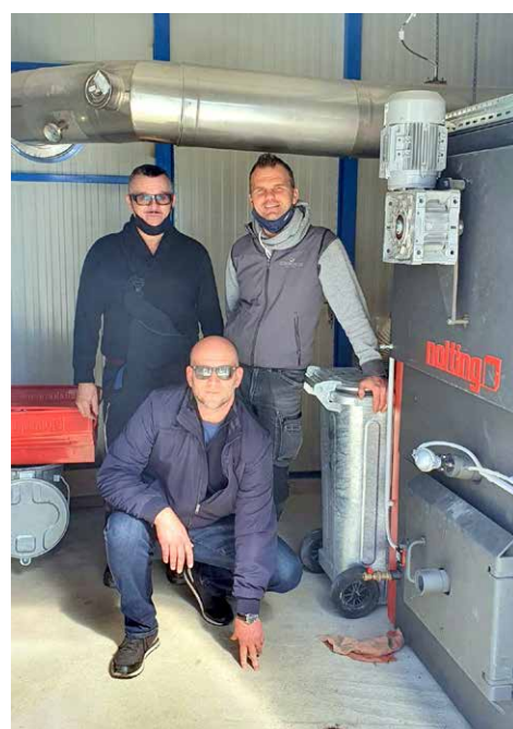
□ Kotao Nolting LCS-RU 215/270 kW u tvornici Elektrometal, Poreč, Hrvatska
